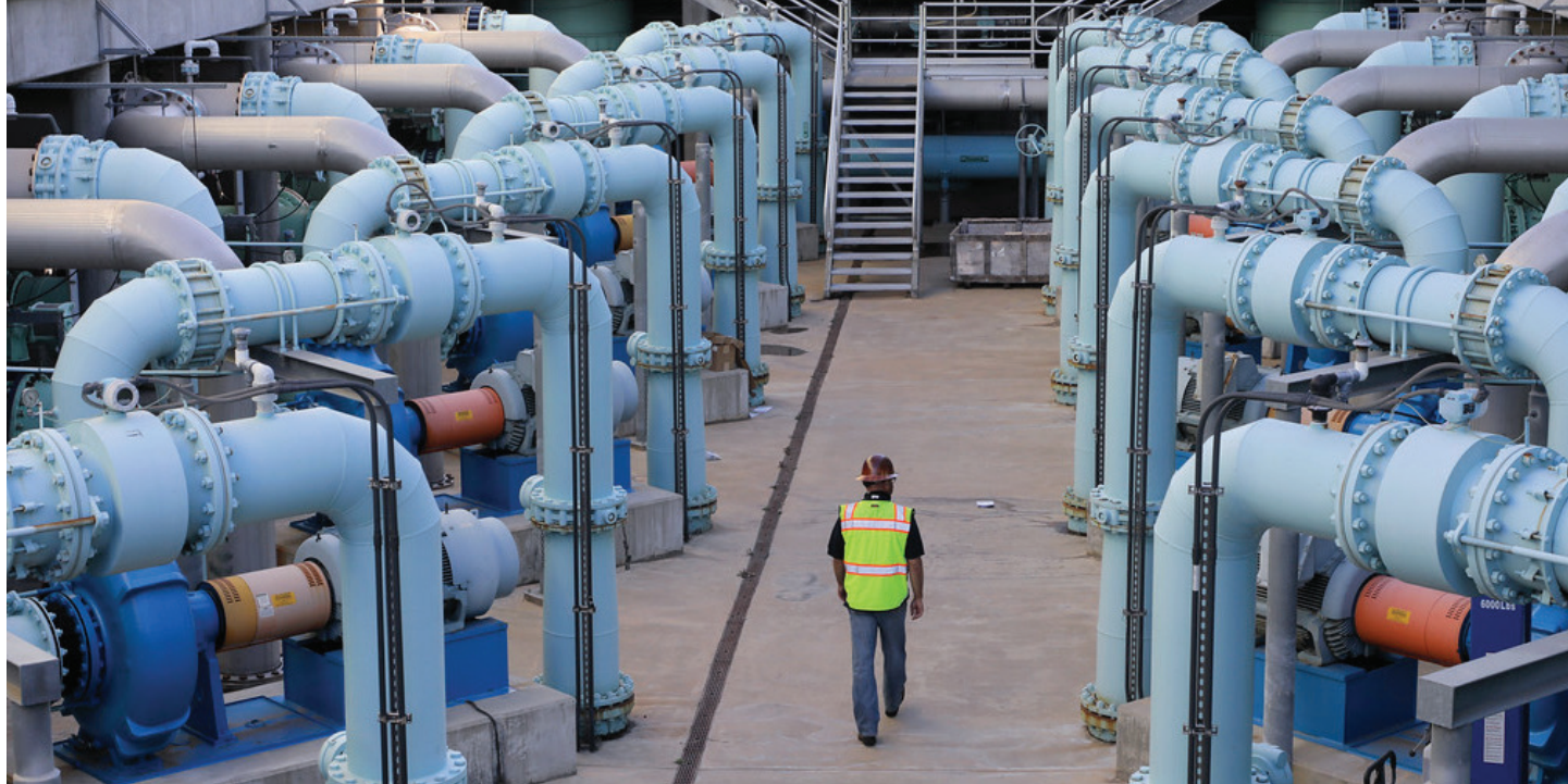
Planta de Tratamiento de Agua Twin Oaks Valley
