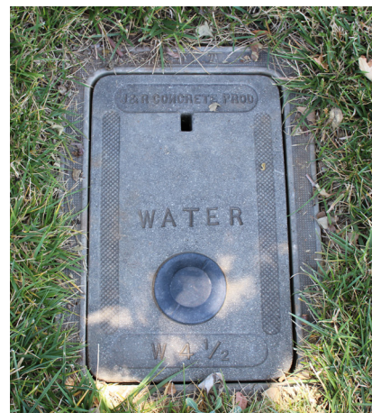
Caja de medidor de agua residencial con dispositivo de medición inteligente.
